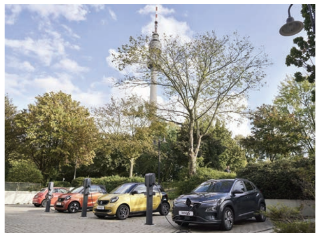
Abbildung 21: Energieladesäulen Quelle: innogy eMobility Solutions GmbH
