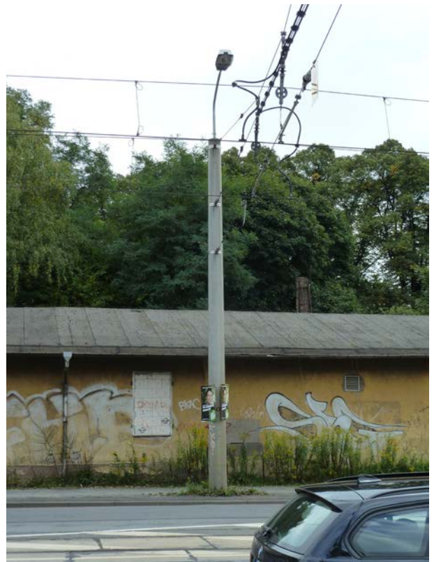
Abbildung 13: Fahrleitungsmast Quelle: Dresdner Verkehrsbetriebe AG
