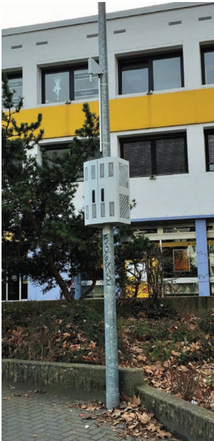
Abbildung 8: Small Cell-Installation mit Umschlussgehäuse an einer Laterne Quelle: Deutsche Telekom
