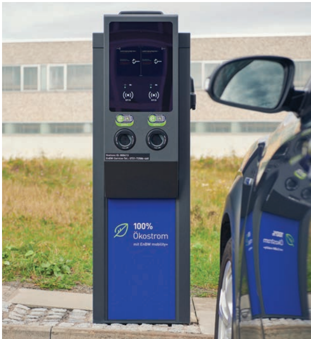
Abbildung 22: Ladesäule Quelle/Rechte: EnBW AG, Fotograf: Endre Dulic
