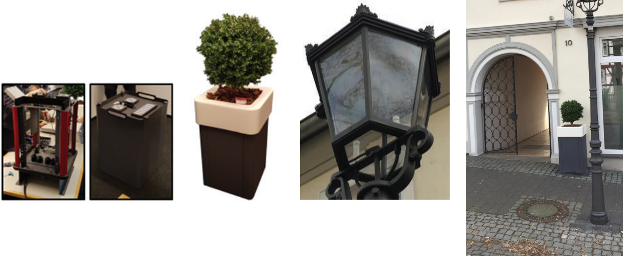
Abbildung 7: Small Cell-Installation an einem Beleuchtungsmast mit camouliertem Nebensterler Quelle: Telekom, Raycap
