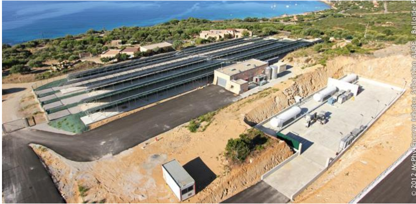
Abbildung 28: PtG Anlage auf Korsika (Quelle: McPhy Energy, Photo: Sébastien Aude, Balloide Photo)
