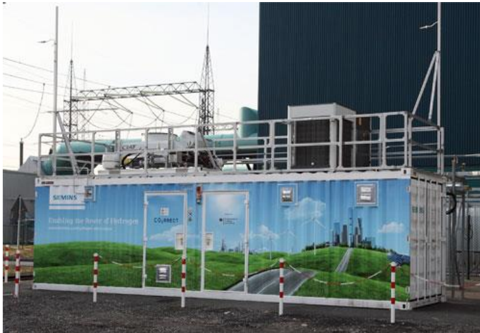
Abbildung 22: Elektrolyseanlage am Kraftwerk Niederaußem (Quelle: RWE)
