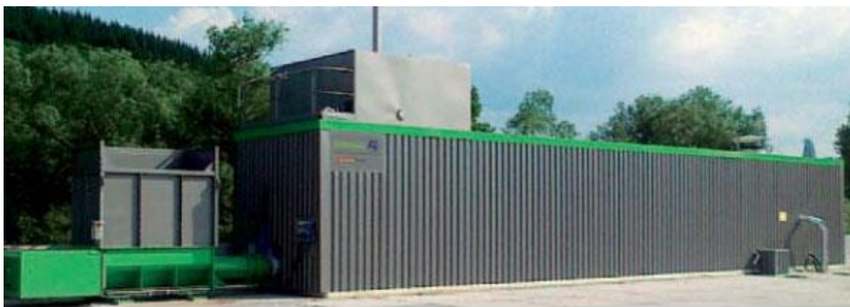
Abbildung 23: Kompaktbiogasanlage „EUCOLino“ in Schwandorf (Quelle: MicrobEnergy GmbH)
