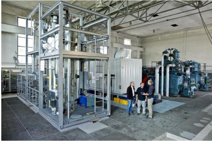
Abbildung 24: PtG Anlage am ZSW in Stuttgart (Quelle: ZSW Stuttgart)
